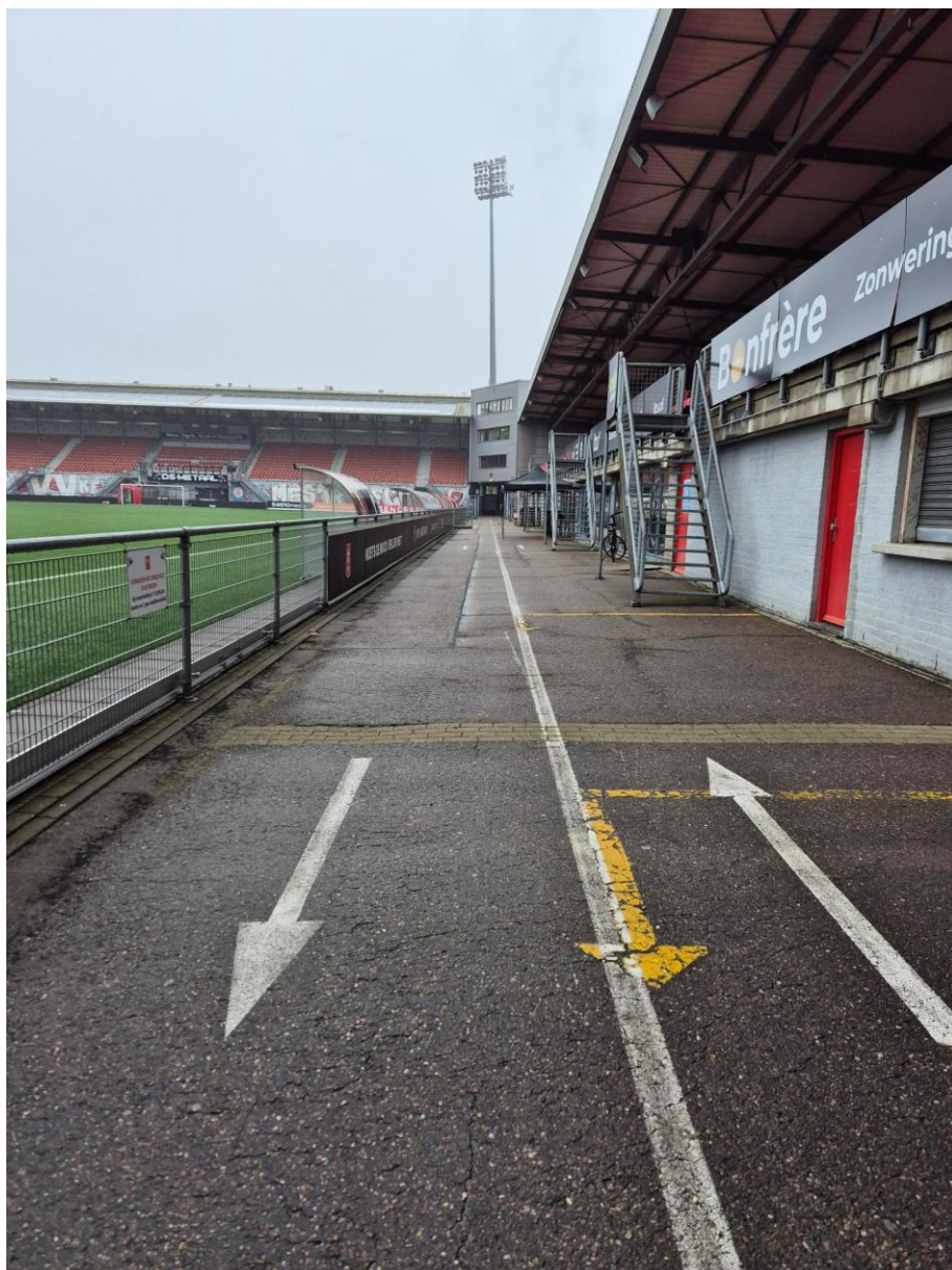
Foto III: De scheuren in de gracht
